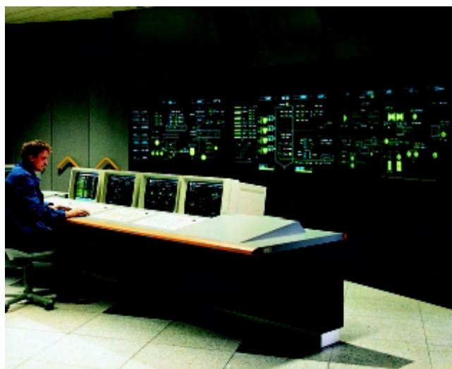
现场总线控制系统
