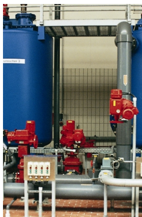
DREHMO®电动执行器 应用在某供气站中
